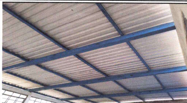
Foto 1: Manera en que se quedó colocado costaneras y el techo (troquela) de 23 pies
