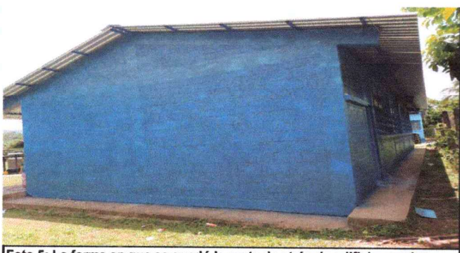
Foto 5: La forma en que se quedó la parte de atrás de edificio escolar (aulas y bodega)
